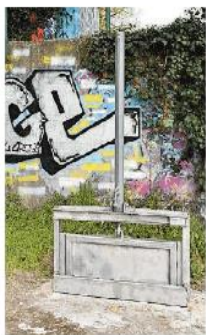
Una delle due nuove paratoie installate da Asm Pavia Spa
