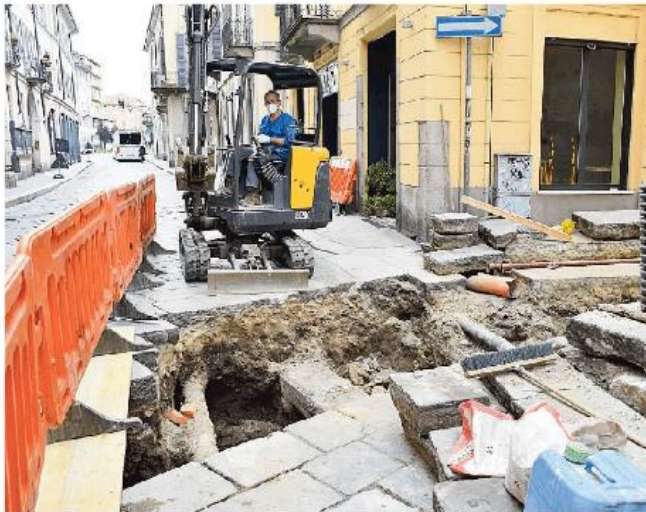
Il cantiere di via del Teatro si è allargato: la situazione della fognatura è molto più grave del previsto
