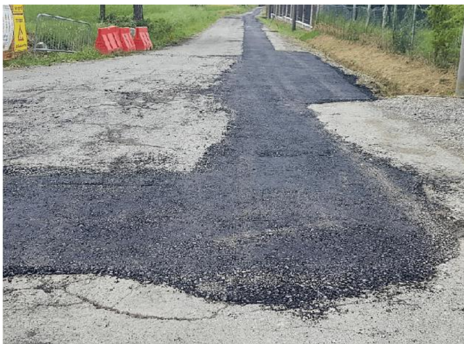
Il Comune di Voghera ha lasciato strada Ferretta in queste condizioni dopo i lavori di Asm
