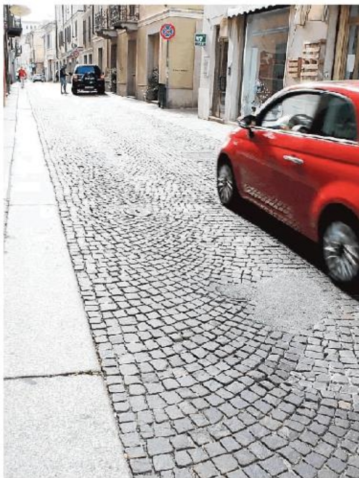
Il porfido danneggiato in corso Josti, dove sono previsti i lavori
