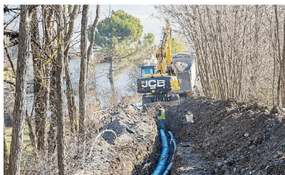
Lavori per la rete di acquedotto che dovrebbe potenziare la prima parte della valle Staffora
