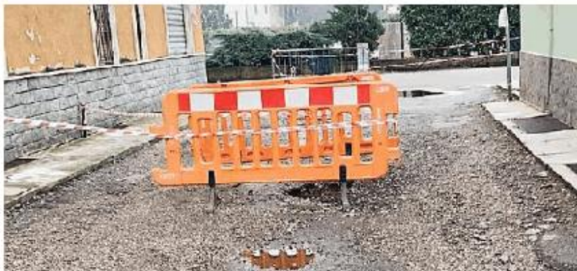
Il cartello posato in via Romagna dopo la comparsa di un buco
