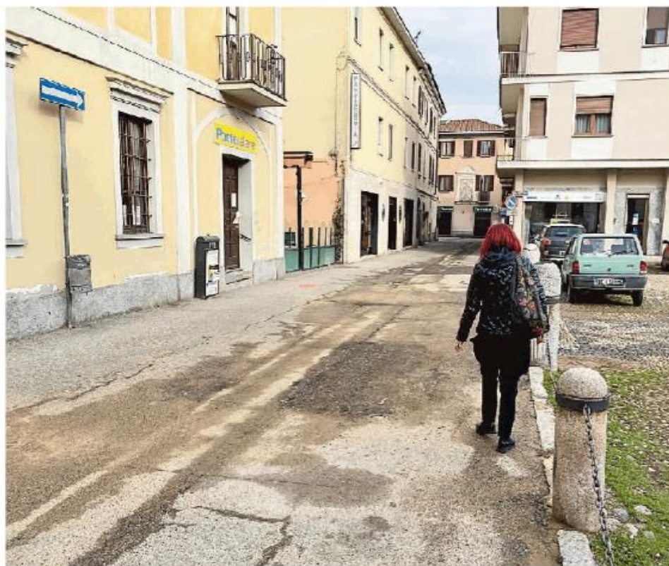
Il guasto in via Cattaneo riparato dopo l'ennesimo guasto della rete idrica cittadina
