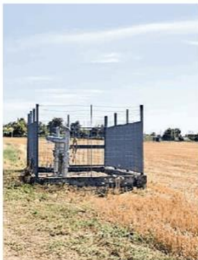
La pompa che si era guastata
