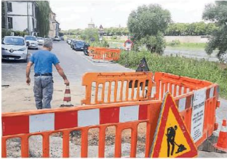
Il punto in cui lavoreranno fino ad oggi gli addetti di Asm Pavia
