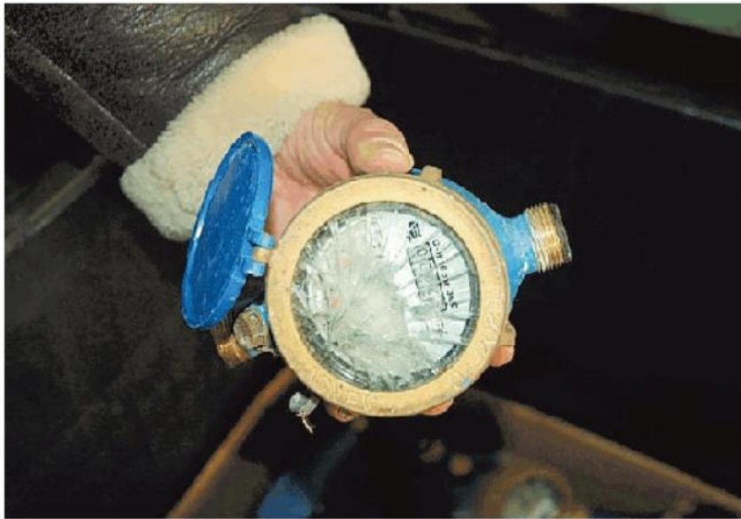
Nella foto d'archivio un contatore dell'acqua danneggiato dal gelo
