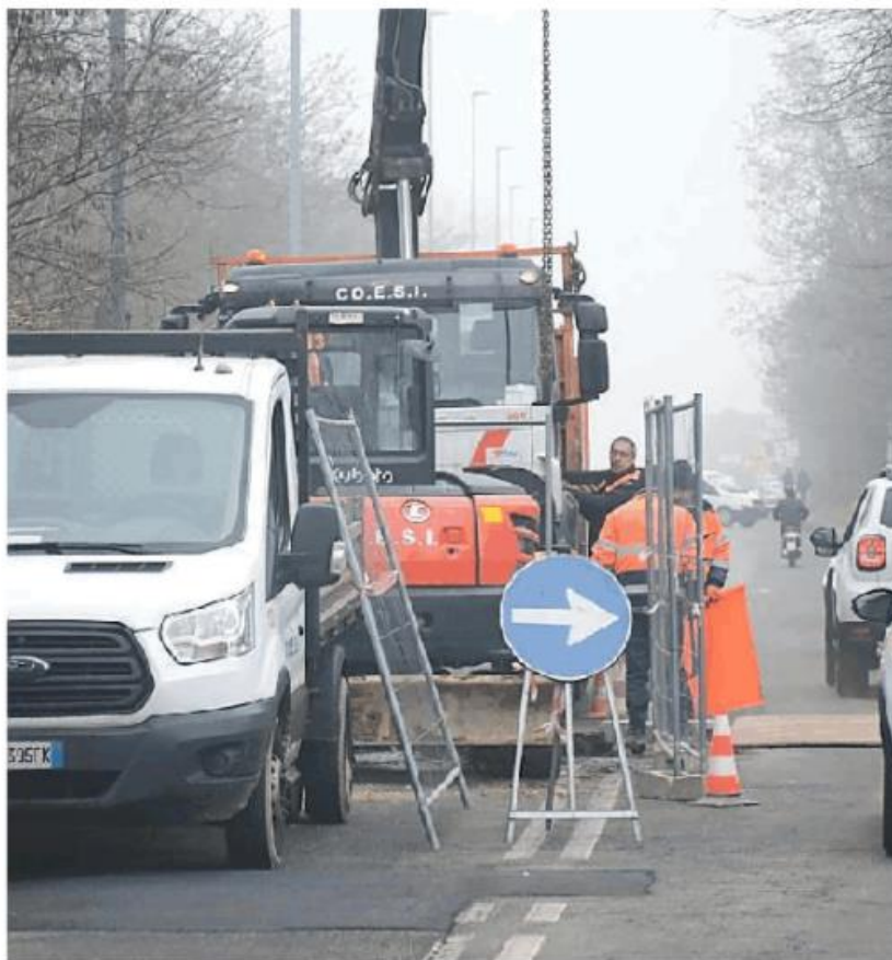
Il cantiere riaperto ieri in via Torretta per il cedimento della fogna
