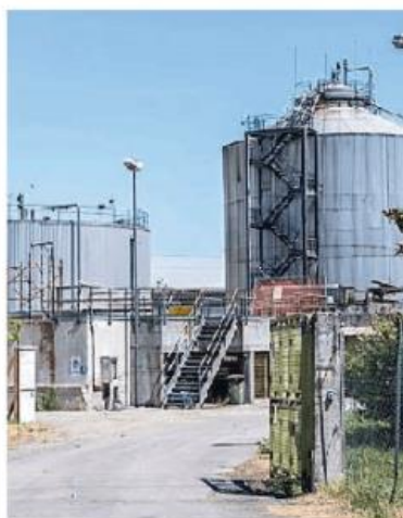
L'impianto di trattamento Forsu
