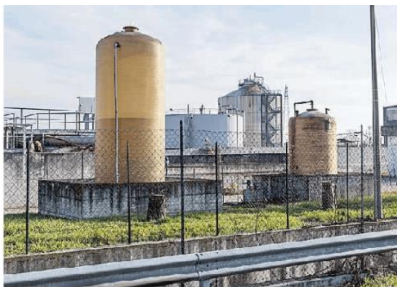
L'impianto di trattamento rifiuti (Forsu) dell'Asm
