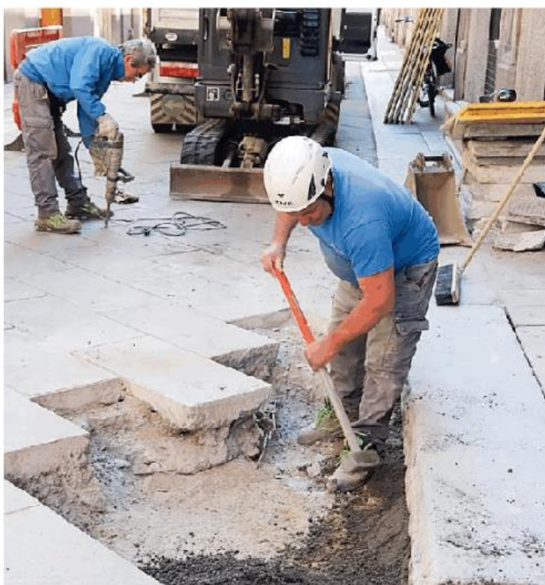
ST. PR. I lavori in centro per la sistemazione della rete fognaria
