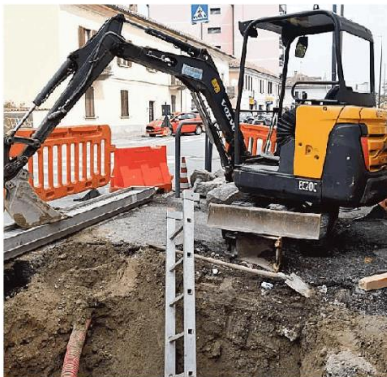
Mezzi al lavoro da ieri in via dei Mille per tamponare la falla
