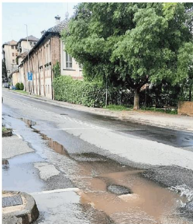
Via Torretta allagata per l'ennesima rottura della fogna
