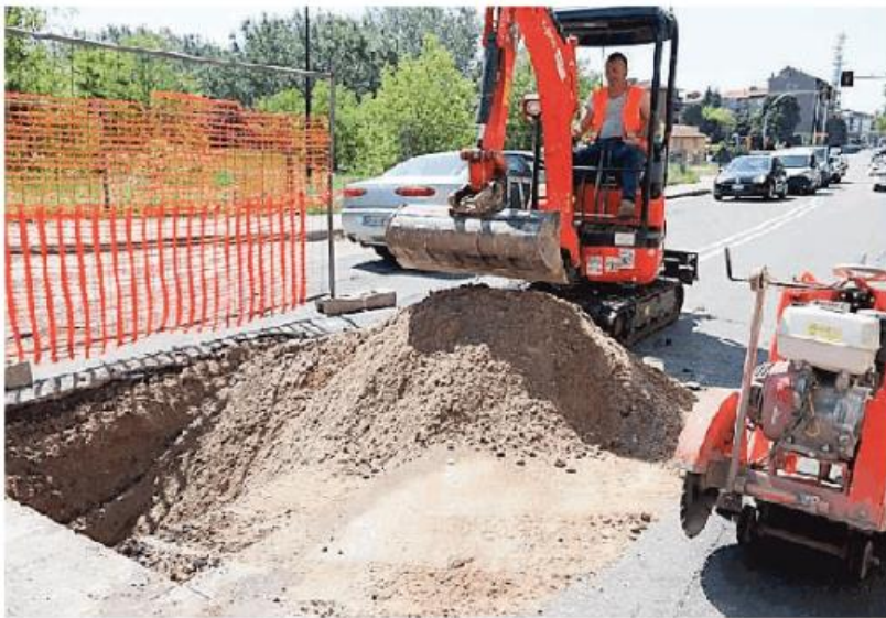
Le ruspe al lavoro in via Torretta ieria a senso unico alternato
