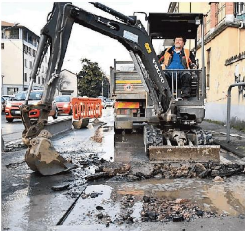
Acqua dispersa per il guasto di un acquedotto
