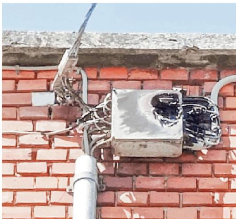
Una delle centraline elettriche rimaste danneggiate dal maltempo
