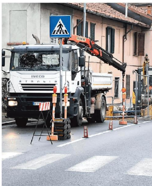
I primi scavi del cantiere per riparare la fognatura in via Fasolo
