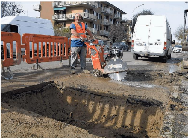
Un operaio dell'Asm al lavoro ieri mattina per riparare il guasto che si è verificato in via Bonfante
