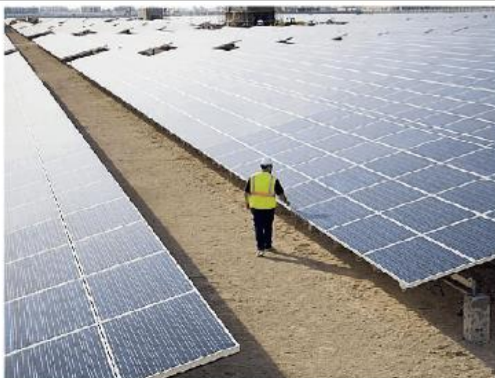
Un parco fotovoltaico per la produzione di energia elettrica
