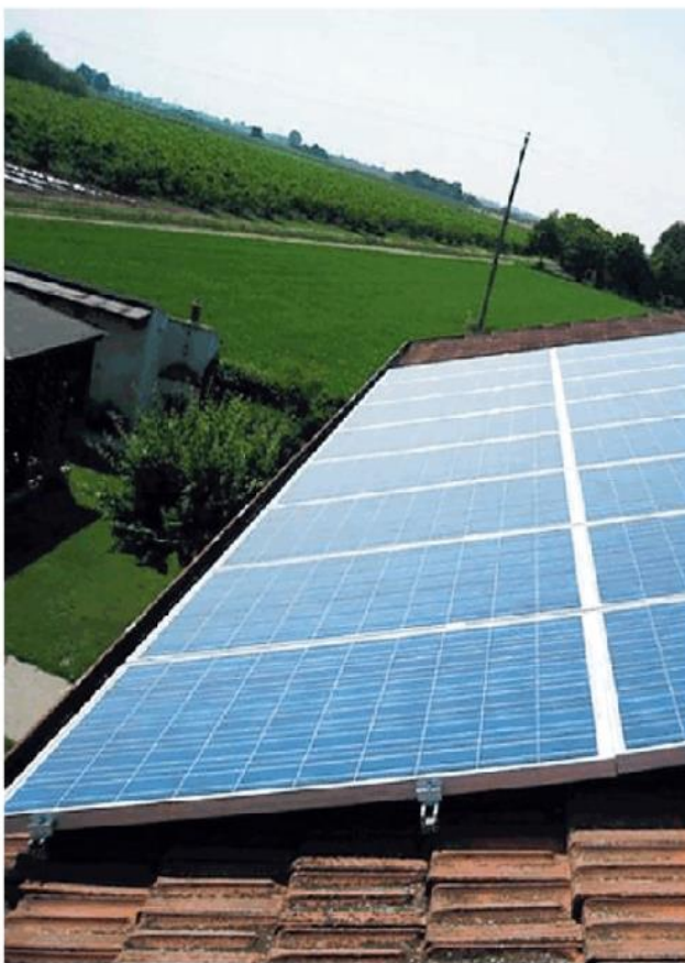
Pannelli fotovoltaici su un tetto: l'energia sarà condivisa
