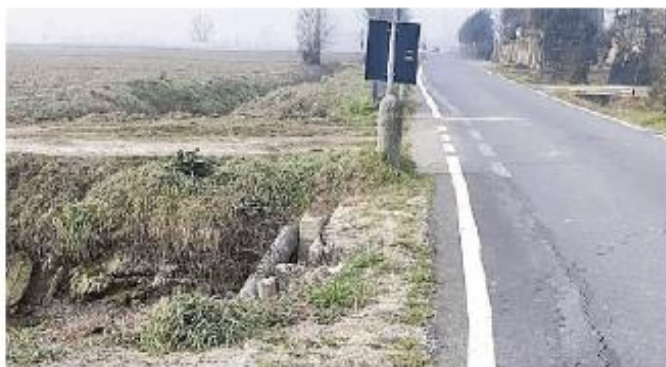
Il ponticello pericolante all'entrata della frazione Turago
