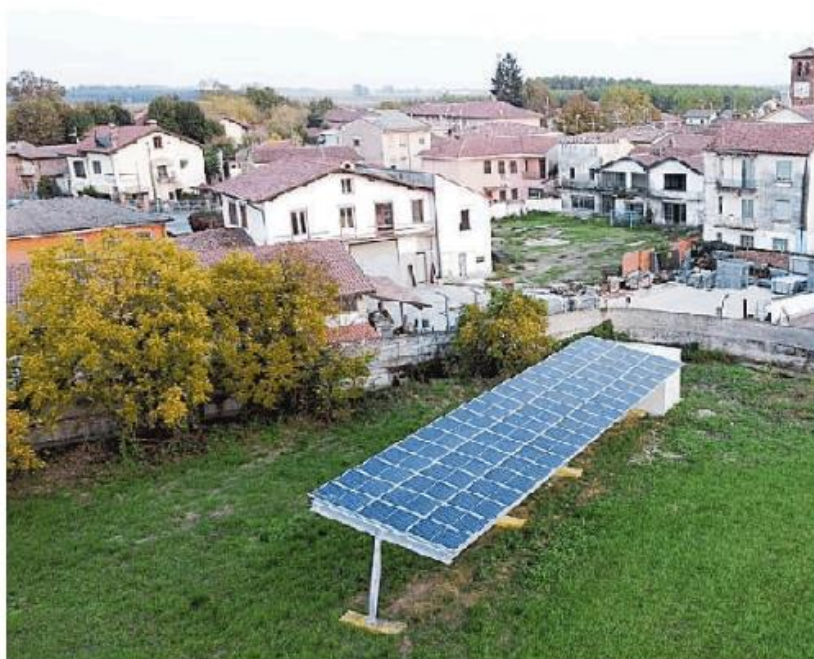
L'impianto fotovoltaico del Comune di Torre Beretti
