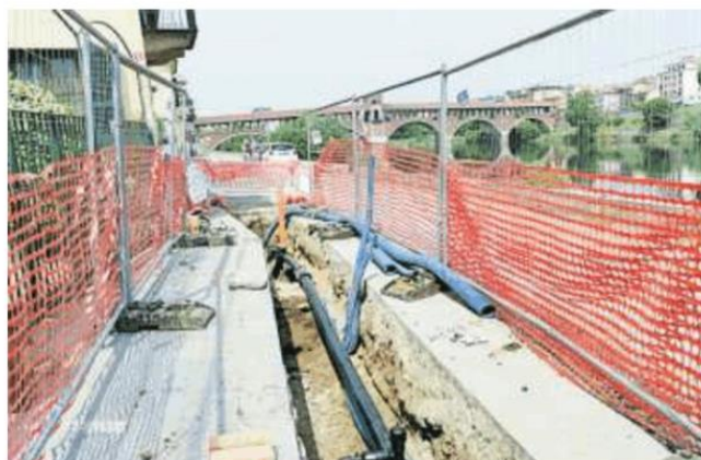
Il cantiere in via Milazzo, dove sono intervenuti gli operai di Asm
