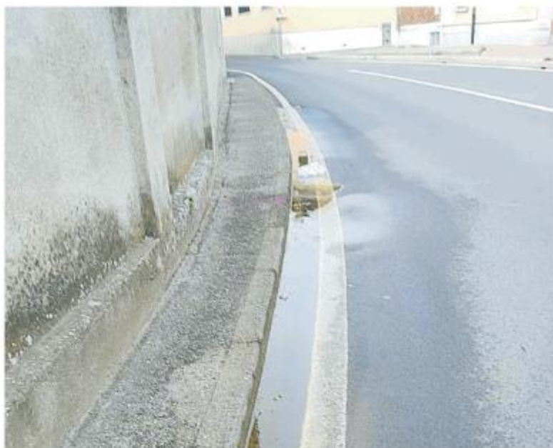
La perdita da una tubatura in via Vittorio Emanuele
