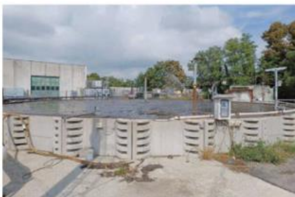
Una delle vasche di depurazione esistenti a Cilavegna
