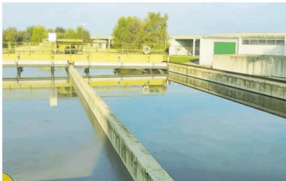
Le vasche del depuratore di strada Folciana: vi sono alcuni difetti di tenuta delle vasche stesse
