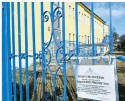
Il cartello che vieta l'accesso alla scuola sotto sequestro
