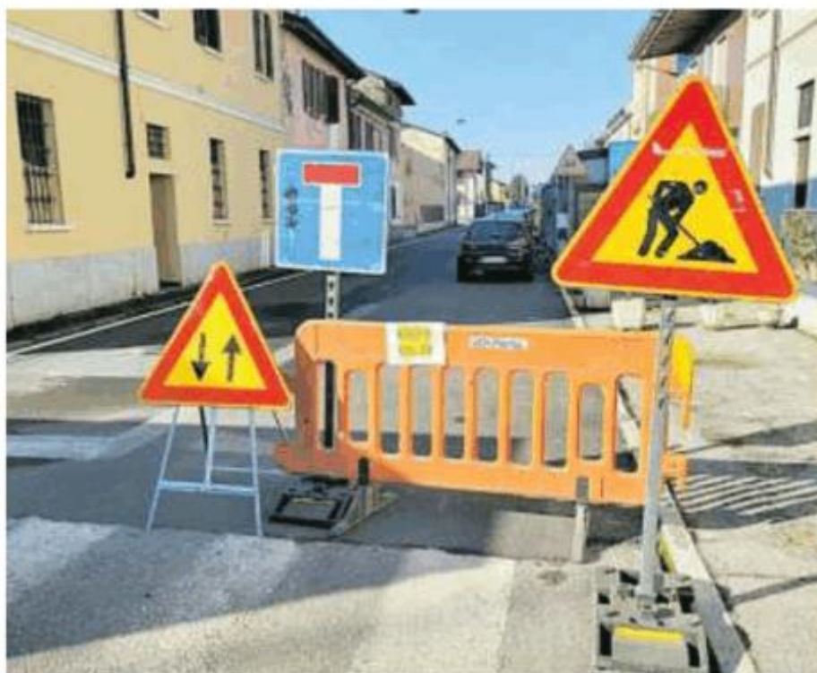
Il tratto interrotto di via Marconi a causa di un guasto della fogna
