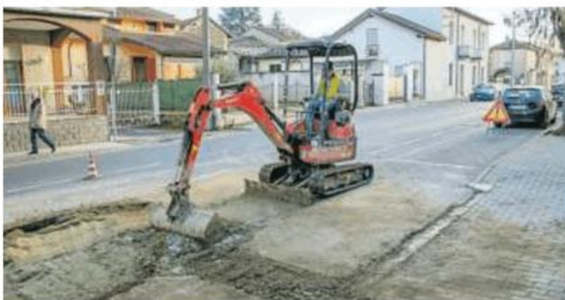
I lavori in corso alla rete idrica a Casteggio, si lavora anche a Montebello
