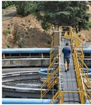
Depuratore di via Montefiascone
