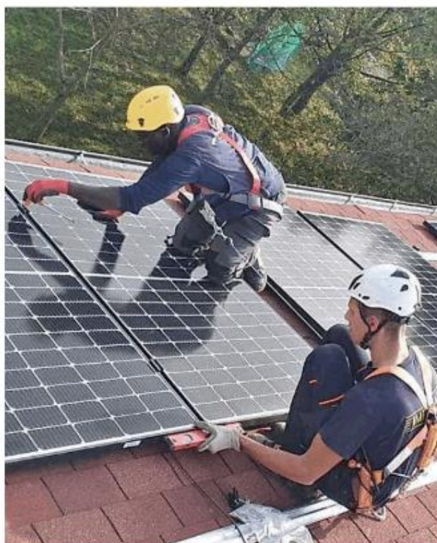
L'installazione di pannelli fotovoltaici per la produzione di energia
