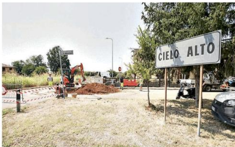
Il cantiere operativo ieri nella zona residenziale Cielo Alto, a Gropello Cairoli
