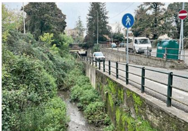
La vegetazione che invade le sponde del Rile a Casteggio
