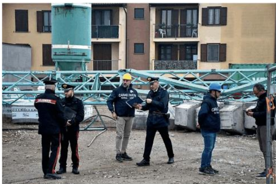
I rilievi sul luogo dell'incidente sul lavoro a Trivolzio del novembre 2022: crollo di una gru e 2 operai feriti
